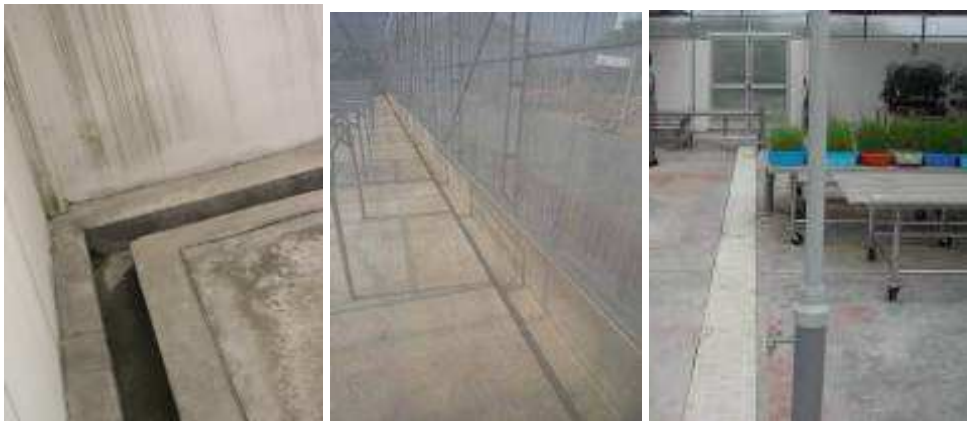
รูปที่ 16 ระบบระบายน้ำภายในโรงเรือน
